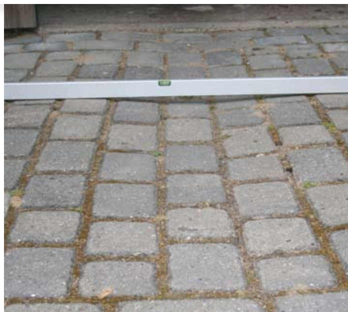
Sporkøring i belægning pga. manglende bæreevne
